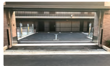
エントランスアプローチ・駐車場ゲートに浮力起伏式止水板を設置
